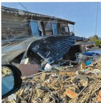
能登町松波地区 津波被害を受けた住宅
